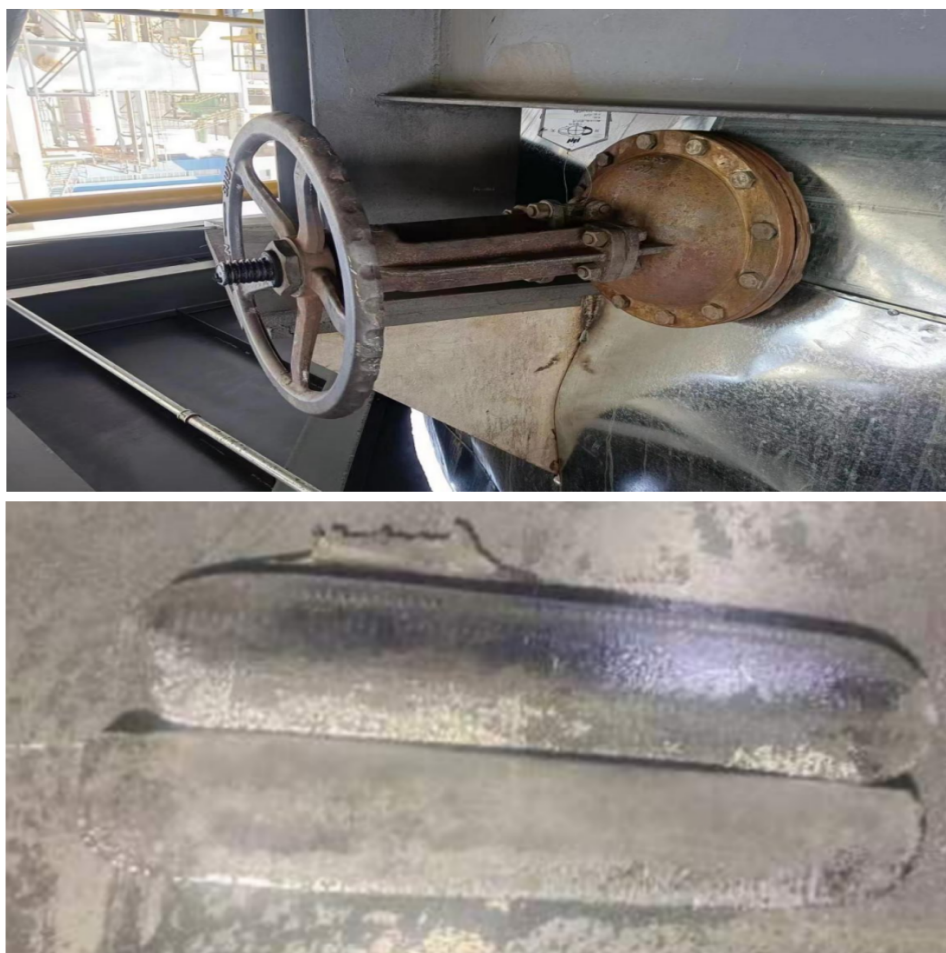
图 3 移动床颗粒除尘装置过滤段卸料电机拨料板托盘插板阀及插板阀中的竖轴与拨料板连接键损坏状况照片
